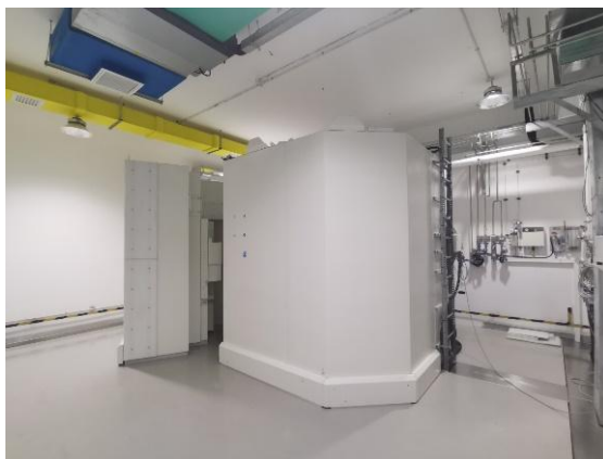
图 3.2-1 PETtrace860 型回旋加速器现场照片
